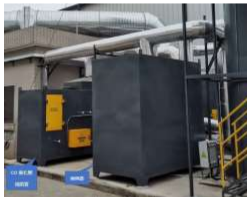
催化燃燒設備
